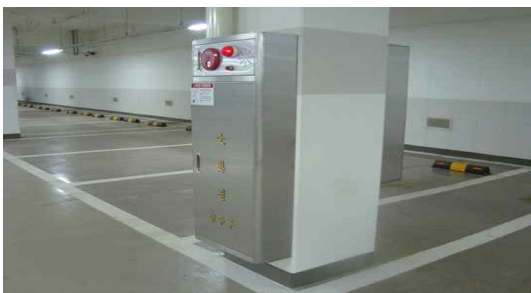
기존 옥내소화전함 및 소화기 설치 이미지
