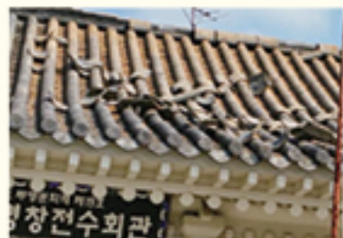
• 무형문화재 전수관 지붕 기와 파손
