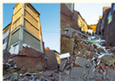
• 환어동 대동빌라 외벽 차장벽돌 탈락
