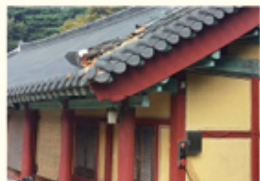
• 불국사 지붕 기와 파손
