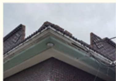
• 주택 지붕 난간 파손
