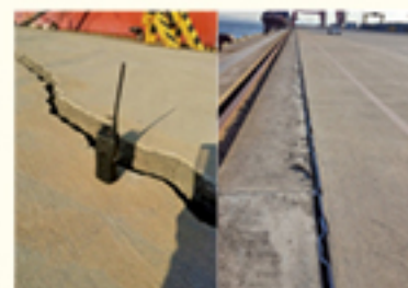
• 영일만항 부두 포장용기 및 균열
