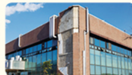
건물 외벽 탈락
