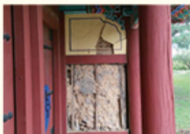
• 신문왕릉 건물 벽체 파손
