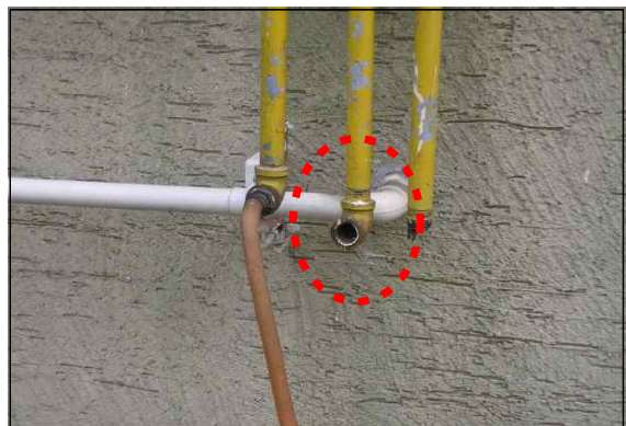
[사용가스 변경 후 기존시설 방치]
