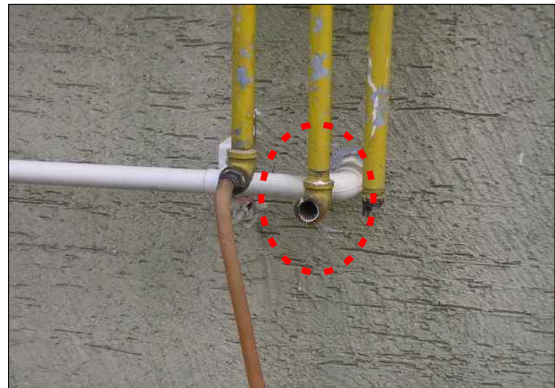
[사용가스 변경 후 기존시설 방치]
