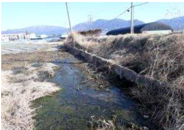
기존 용수로 시설 노후 및 파손
