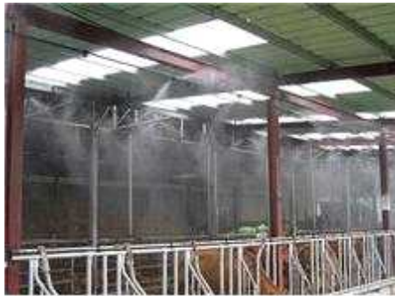
<축사 내부 스프링쿨러>
