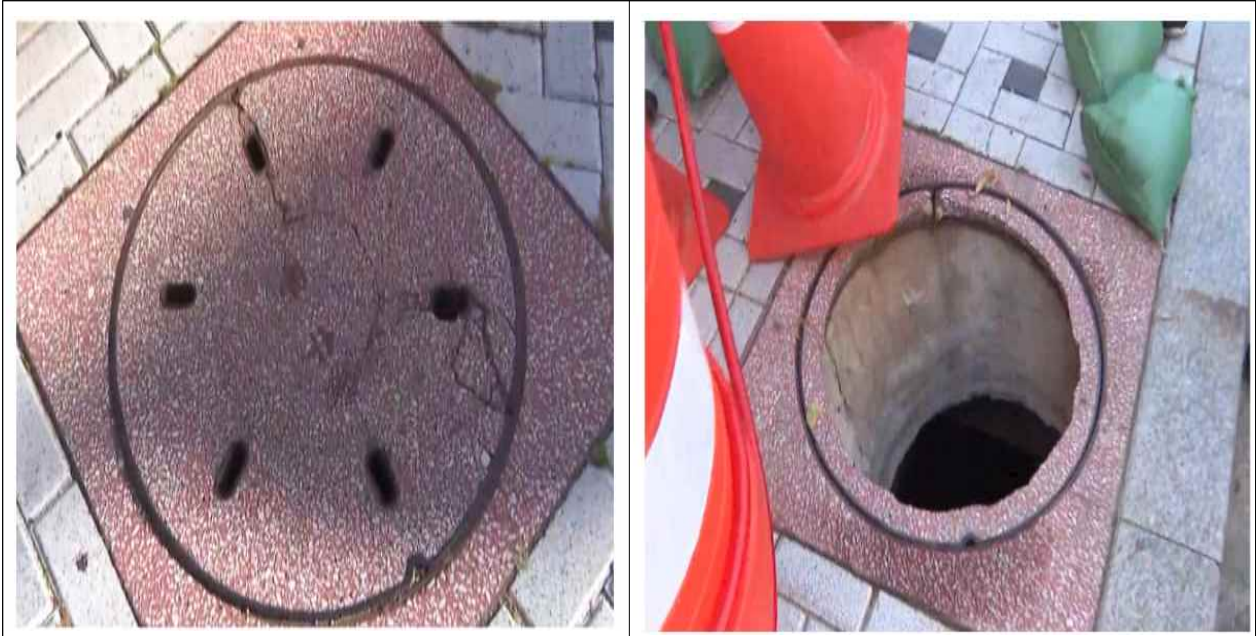
○ 사고 발생 조화 맨홀(부산시 현장)
