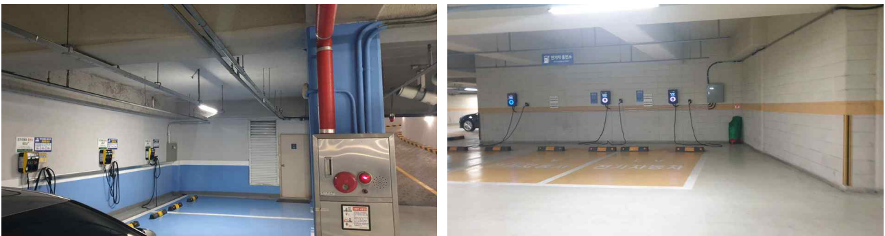
<그림 35> 화재감지기가 설치되지 않은 전기차 충전구역
